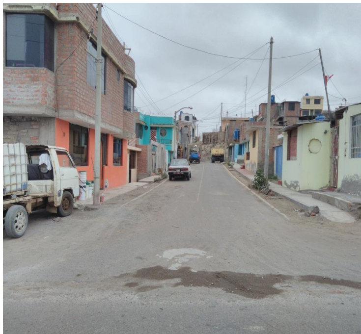
FOTO N° 03: Jr. PACO YUNQUE Falta de Infraestructura Vial. Requiere la construcción de Bermas y Jardineras
