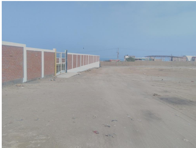
FOTO N° 16: Jr. ESCALAS - AREA RECREACION- AREA EDUCACION Falta de infraestructura vial. Requiere la construcción de Veredas, Bermas, Sardinell, Jardineras. Se complementará con la construcción de la calzada de la calle.
