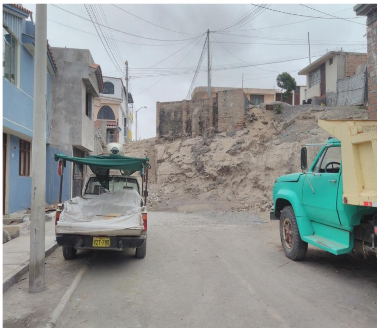
FOTO N° 04: Jr. PACO YUNQUE Requiere el mejoramiento de graderías para acceso peatonal, existen viviendas solo lado izquierdo
