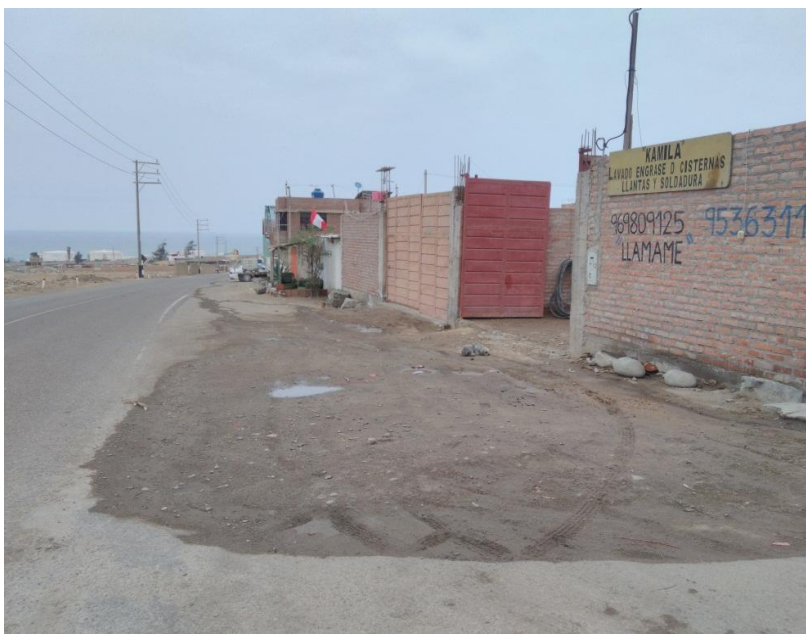
FOTO N° 19: VIA DE EVITAMIENTO– MZ LL Falta de infraestructura vial. Requiere la construcción de Veredas, Bermas, Sardinell y Jardineras.
