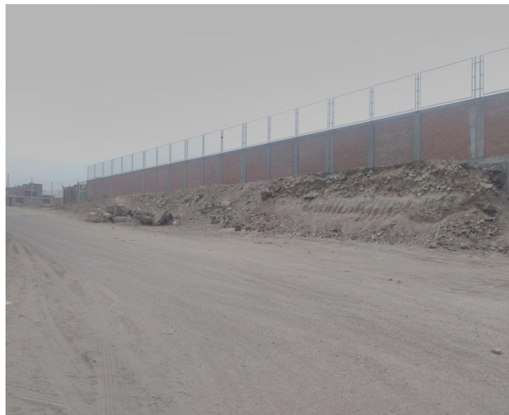
FOTO N° 09: Jr. VIA DE LA CIRCUNVALACION Falta de infraestructura vial. Requiere la construcción de Veredas, Bermas, Sardinell y Jardineras, Complementándose con la construcción de un muro de contención.
