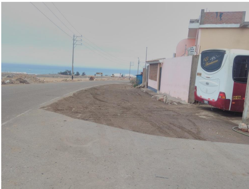
FOTO N° 18: VIA DE EVITAMIENTO– MZ A' Falta de infraestructura vial. Requiere la construcción de Veredas, Bermas, Sardinell y Jardineras.
