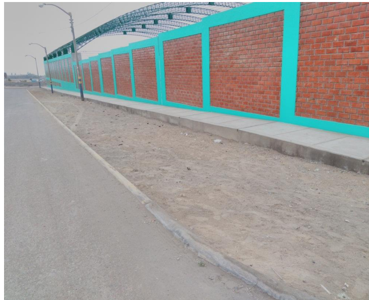
FOTO N° 06: Jr. JUAN PABLO II – LADO AREA DE RECREACION Falta de Infraestructura Vial. Requiere la construcción de Bermas y jardineras
