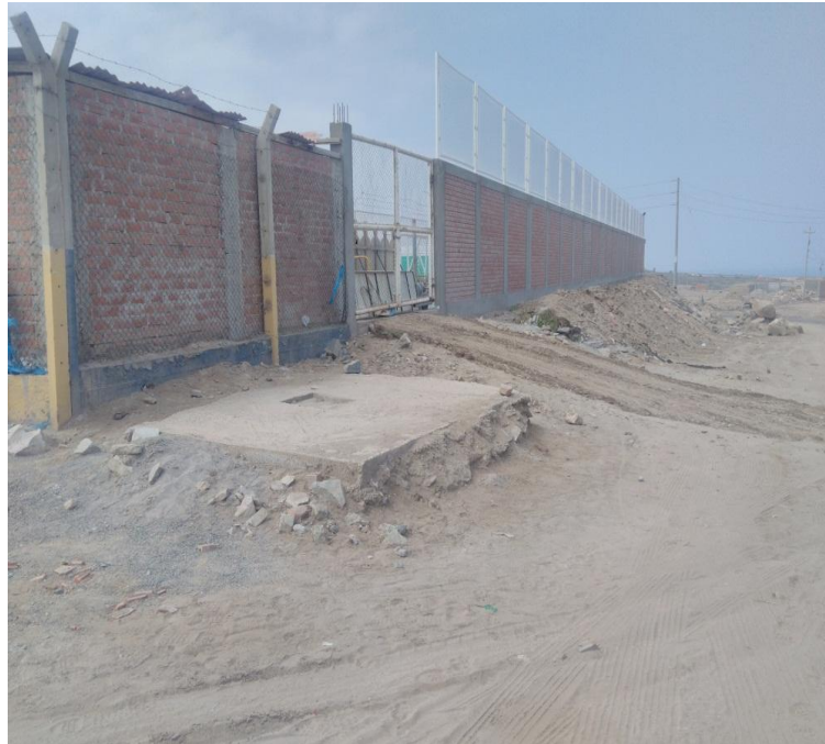
FOTO N° 08: Jr. VIA DE LA CIRCUNVALACION Falta de infraestructura vial. Requiere la construcción de Veredas, Bermas, Sardinell y Jardineras.
